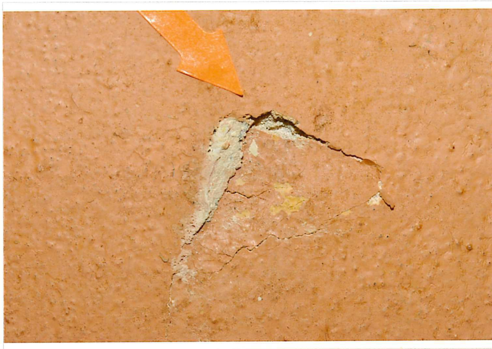
026 Detailaufnahme – mechanischer Schaden
