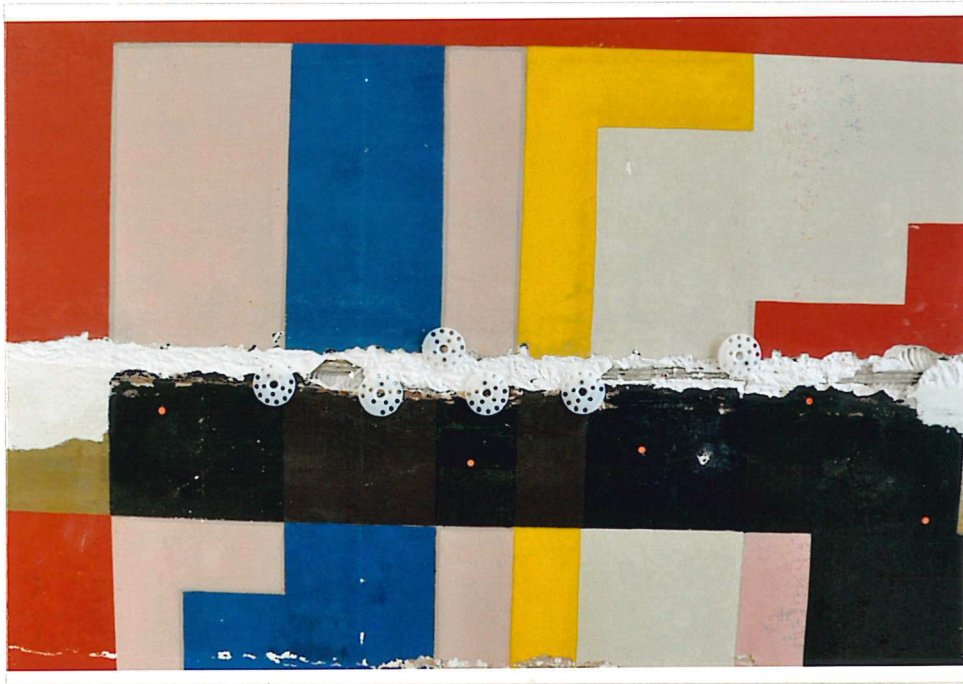
044 Detailaufnahme – Putzsicherung am Deckenspiegel
