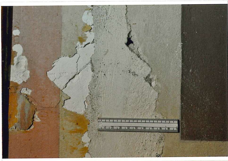
028 Detailaufnahme – mechanischer Schäden am Putz (Elektrokabel mit Putzergänzungen [zementhaltig])
